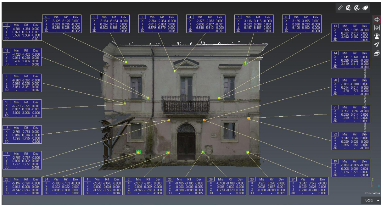
Fig. 7 Santa Maria Argentea (Norcia): facade displacements © Vigili del Fuoco
