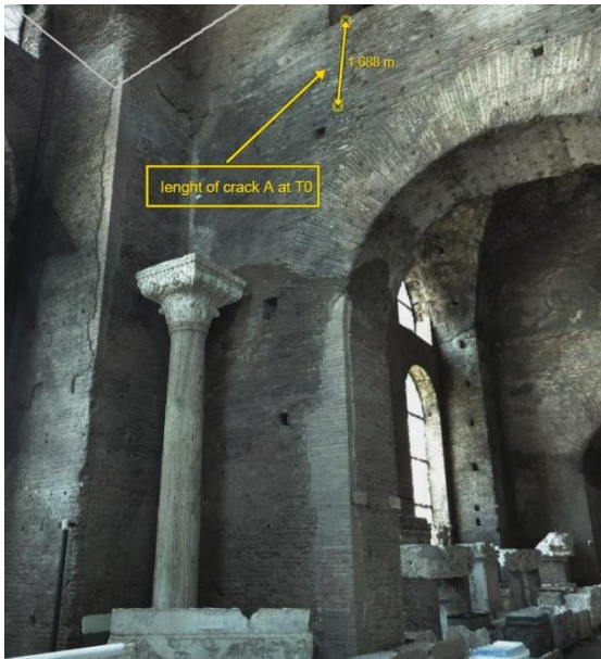
Fig. 1 Terme di Diocleziano (Rome): length of crack A at T0 © Vigili del Fuoco
