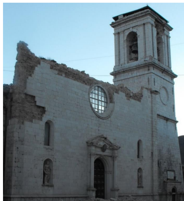
Fig. 6 Santa Maria Argentea (Norcia): facade damages © Vigili del Fuoco
