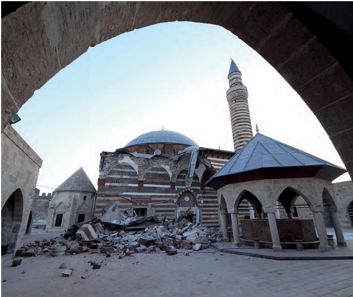
10 Les dommages causés à la mosquée Kaya Çelebi après le tremblement de terre de 2011 dans la Haute Baie de Bakraçli (Turquie)
