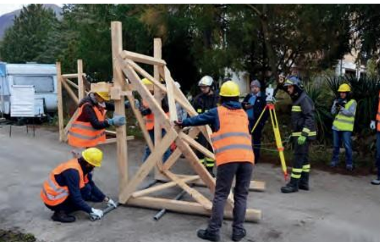
3 Participants mettant en place une structure d'étaie dans un scénario de patrimoine culturel pendant le cours FAC de l'ICCROM, 2019, qui s'est tenu à Rome et à Norcia (Italie).
