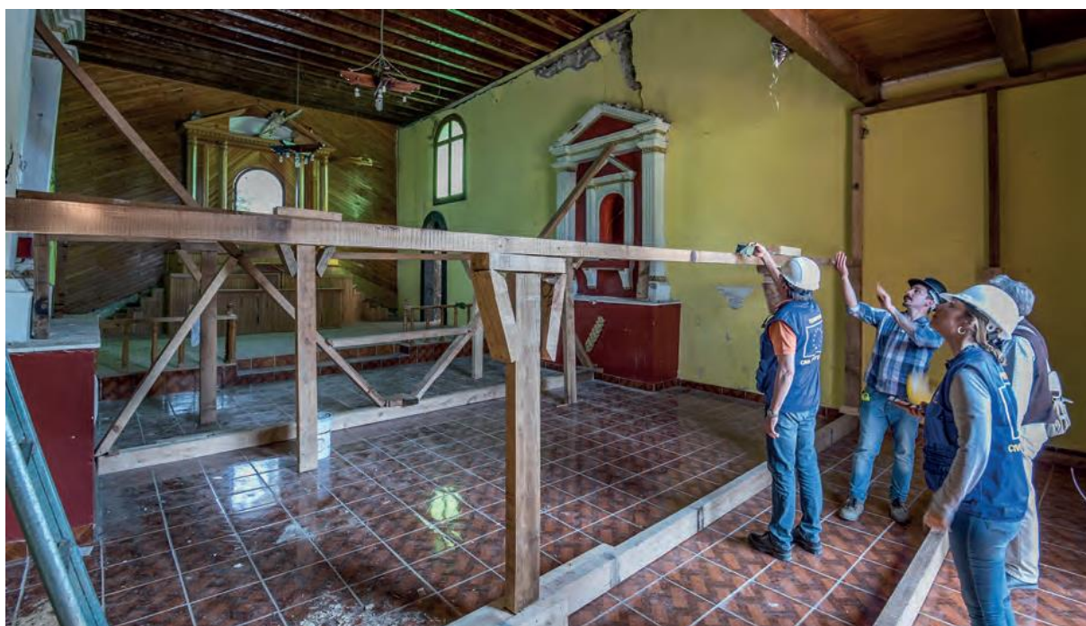
37 L'équipe EUCPT lors d'une inspection du site de San Marcos Tecomaxusco touché par le tremblement de terre de 2016.
