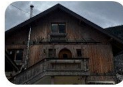
3. Die Außenverkleidung meines Hauses besteht aus brennbarem Material.
