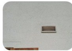
7. Ich habe Lüftungsöffnungen ohne Schutzvorrichtung.
